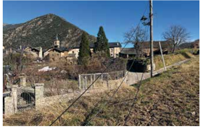
Els fils d'un cable de telèfon arrossegats per terra al municipi de Sort.
