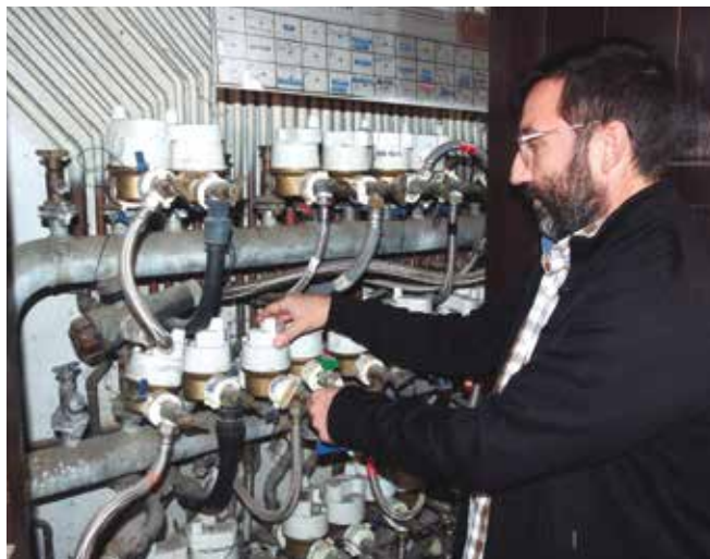
Un tècnic de la companyia d'aigües amb diversos comptadors intel·ligents instal·lats en un bloc de pisos de Begur.
