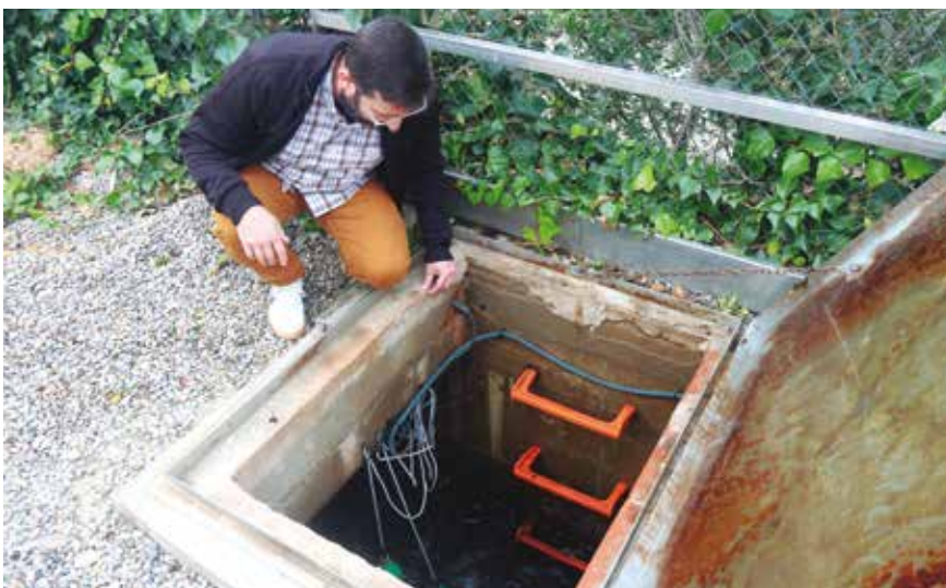
Un tècnic de la companyia d'aigües al costat d'un dels pous que donen aigua a Begur.
